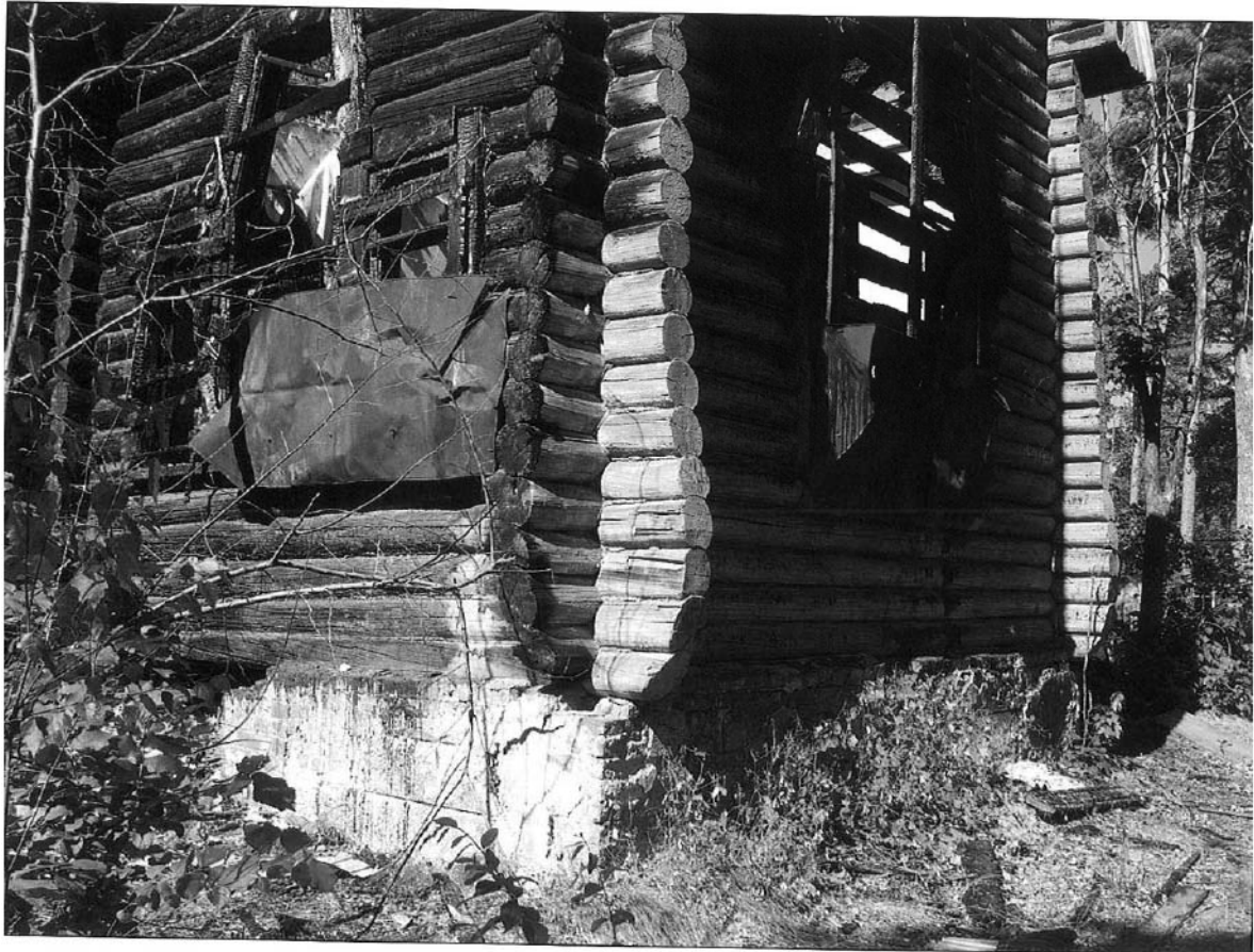
15. 2010 год. Юго-западный и восточный фасады. Фрагмент сруба. Утраты после второго пожара 2009 года.
