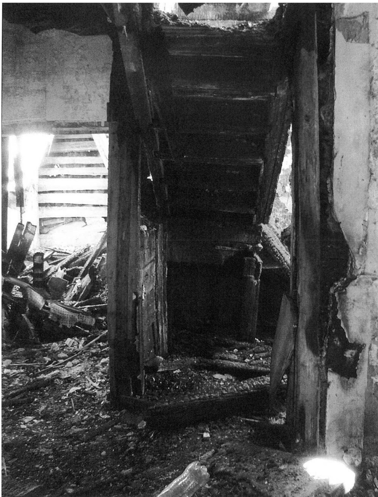
18. 2010 год. Внутренняя лестница. Утраты после второго пожара 2009 года
