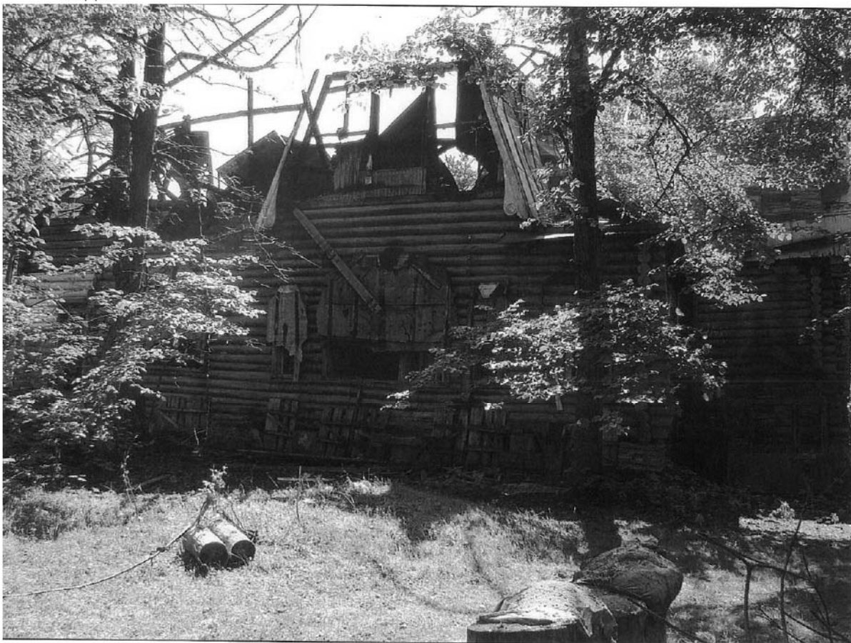
14. 2010 год. Северо- восточный фасад. Утраты после второго пожара 2009 года.
