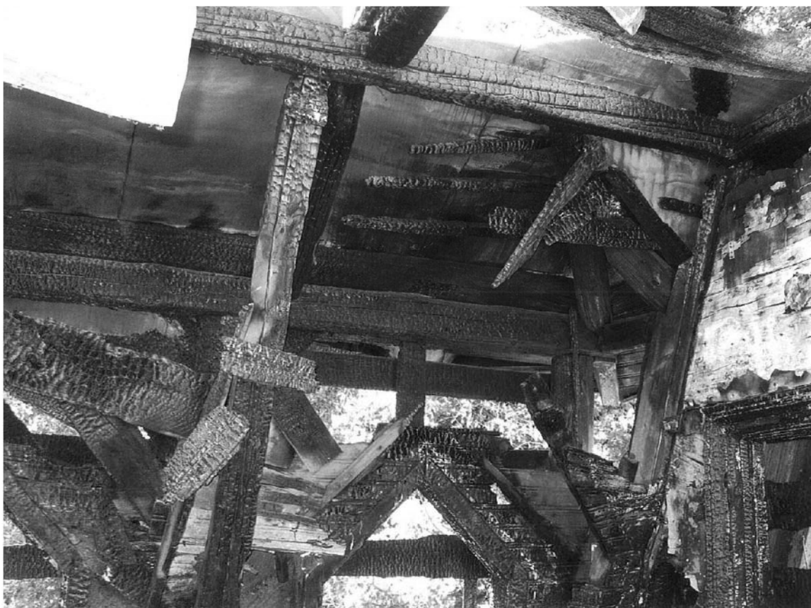
21. 2010 год. Мансардное помещение. Утраты после второго пожара 2009 года
