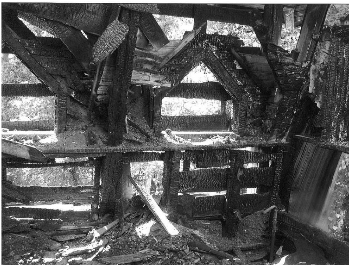
20. 2010 год. Мансардное помещение. Утраты после второго пожара 2009 года
