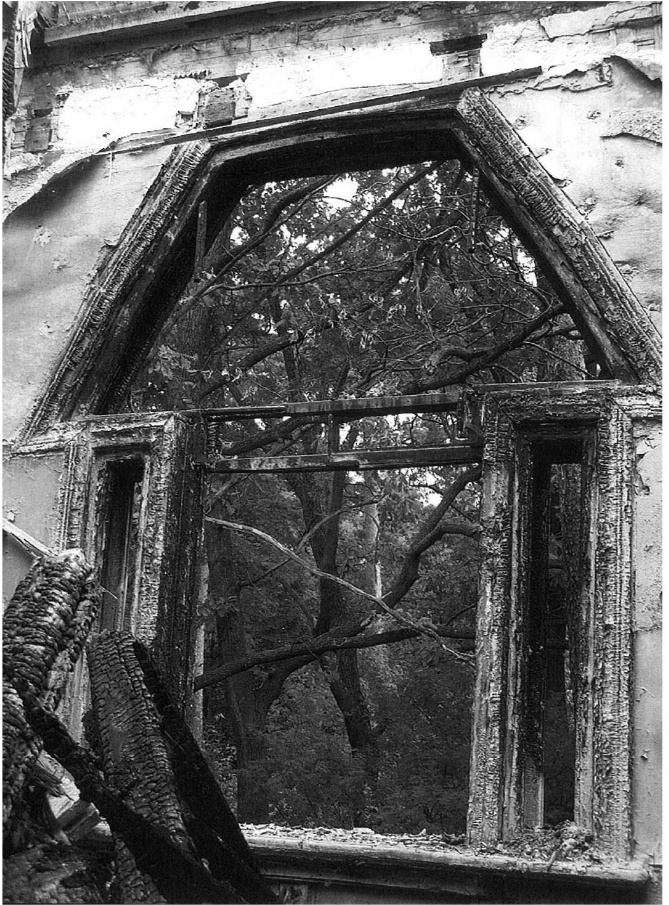
19. 2010 год. Фрагмент. Оконное заполнение. Утраты после второго пожара 2009 года
