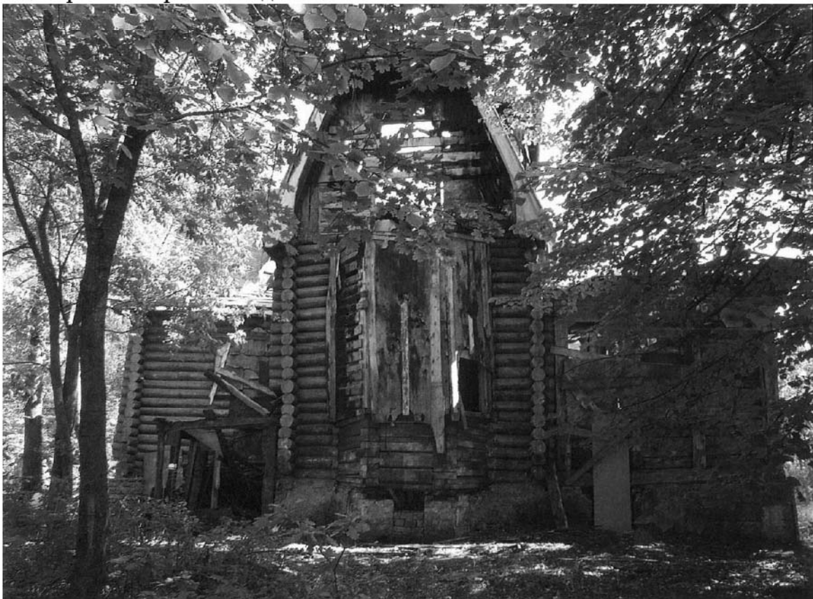
16. 2010 год. Западный фасад. Утраты после второго пожара 2009 года.
