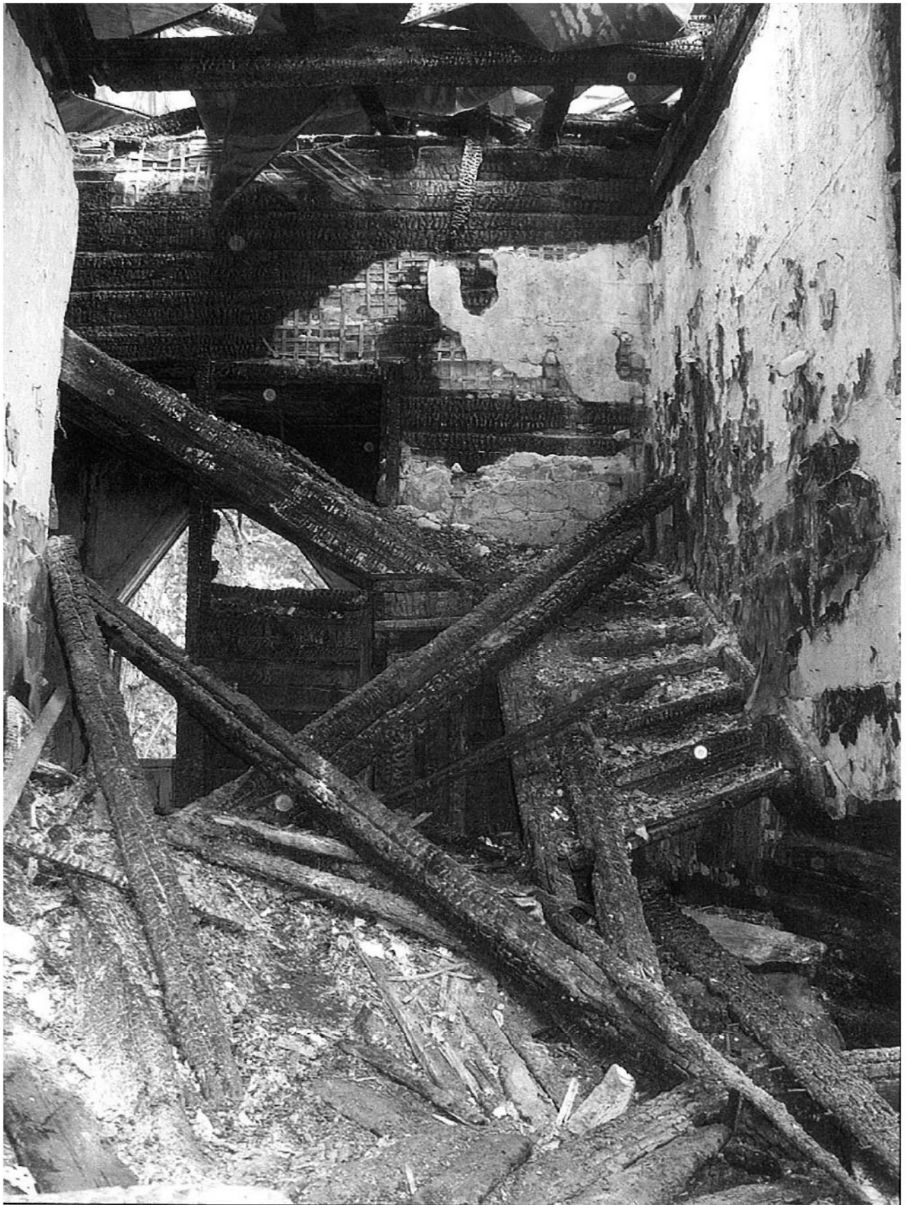
17. 2010 год. Внутренняя лестница. Утраты после второго пожара 2009 года.
