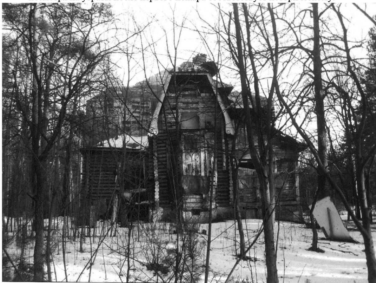
10. 2008 год. Западный фасад. Объемно-пространственное решение, несмотря на утраты после первого пожара соответствует историческому.
